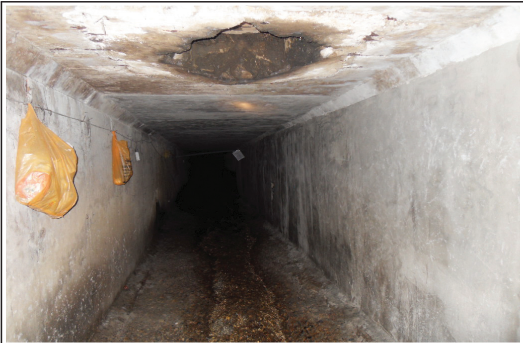
재해발생 현장전경(맨홀아래 지하 우수박스 내부)
